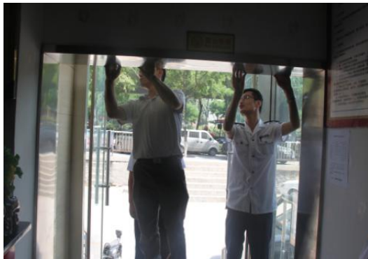
进门入口处安装塑料门帘、风幕机等防蝇设施，门帘底部离地面不大于 2 厘米
