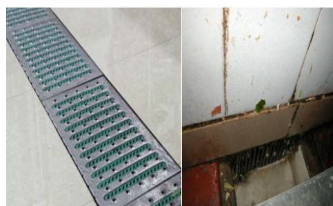
有食堂或餐饮服务的“五小”行业，操作间排水沟严密封闭，出水口安装可拔插而严密的铁栅栏，缝隙不大于 10 毫米
