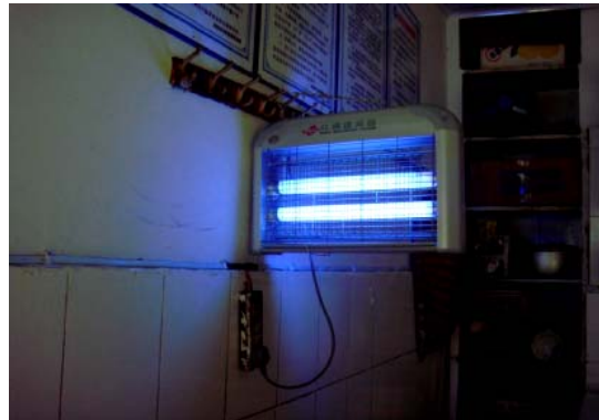
室内设置灭蝇灯，距离墙面 20 厘米以上高度，保持常亮状态，30-50 平米设置一台
