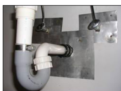
墙上的孔洞用硬物封闭（或堵塞）
