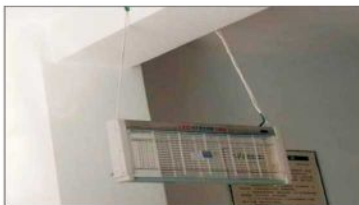
餐厅、厨房、食品库房等房间安装灭蝇灯,灭蝇灯不得靠墙,距离墙面20厘米以上,并保持常亮状态
