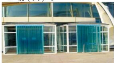
餐厅、操作间等重点场所入口处安装塑料门帘、风幕机等进行防蝇,塑料门帘底部离地面不大于2厘米
